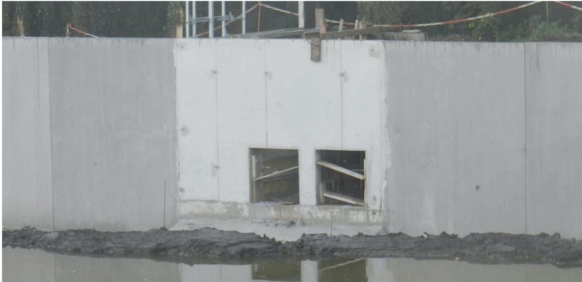
Figure 21 : Vannes I1 et I2 de la digue de Moulin Neuf
