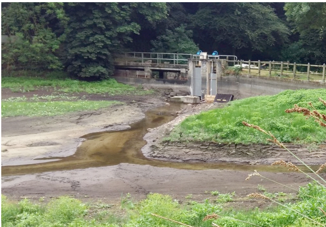
Figure 22 : Au centre sont visibles les vannes E1 et E2 sur la retenue de Baniguel en 2012 (source Syndicat)
